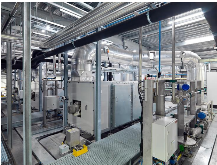
Decke mit der Verfahrens- Anlagentechnik der ProCarbonCure – Kammer- Aushärteanlage für CO2-negative Vormauersteine
